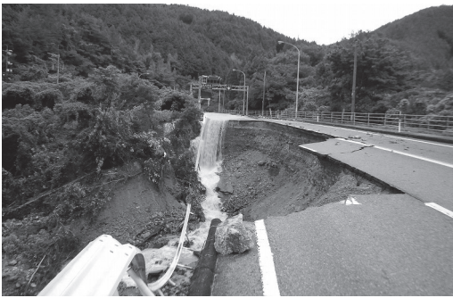
平成25年7月の豪雨災害（国道191号線）
