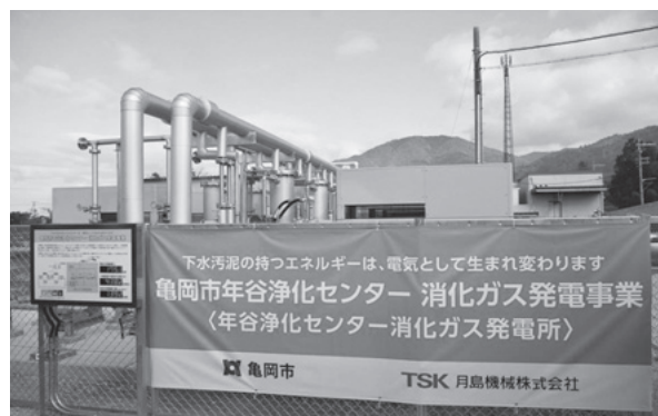
2020年12月から始まった消化ガス発電事業
